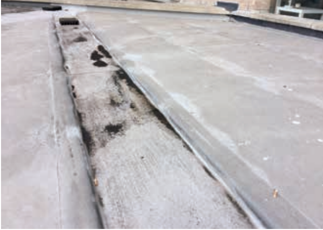
De oude dakbedekking lekte ter plaatse van talloze bouwkundige details. Er waren weliswaar herstellingen uitgevoerd, maar zonder blijvend resultaat.
