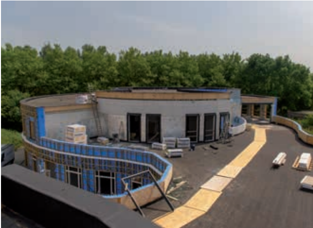
De Ring bestaat uit drie ronde gebouwdelen met woonunits en daartussen ruimtes voor dagbesteding en activiteiten. Op de HSB gevelwanden is een houten regelwerk bevestigd waarop de Eternit bekleding komt. De daken verschillen in materialisatie en aankleding. Meest opvallend wordt het groen- en terrasdak.
