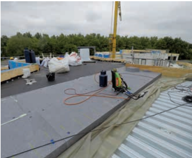
Op de geprofileerde stalen dakplaten is EPS isolatie en APP-gemodificeerde dakbedekking aangebracht. De dakranden hebben een draagstructuur van hout.
