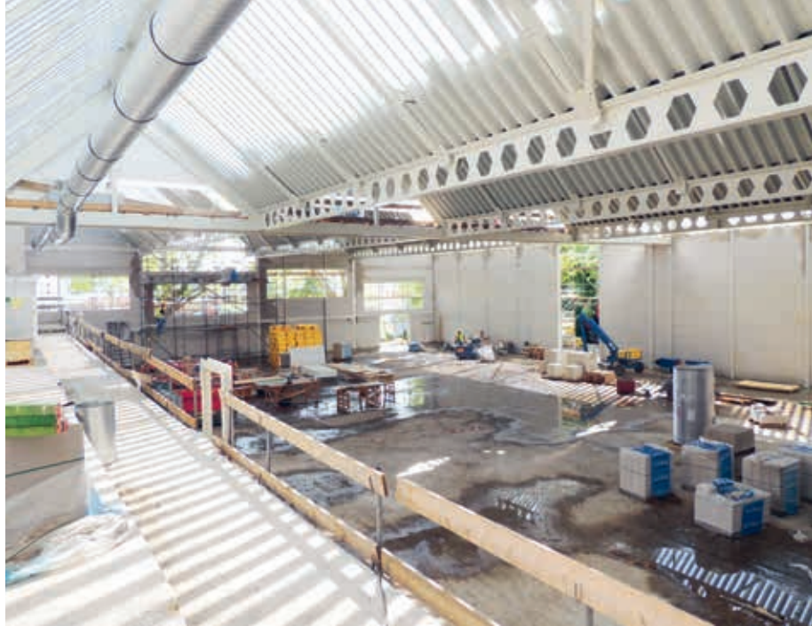
De kappen van de sporthal en andere ruimtes worden akoestisch uitgevoerd. In de cannelures van de geperforeerde geprofileerde stalen dakplaten komt geluiddempende minerale wol. Het dak van de sporthal wordt voorzien van drie ramen van 2900 bij 1750 mm.
