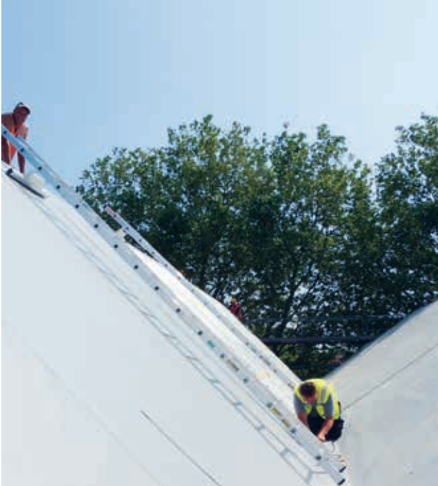
Om veilig en efficiënt te werken, gebruiken dakdekkers speciale, op maat gemaakte ladders.
