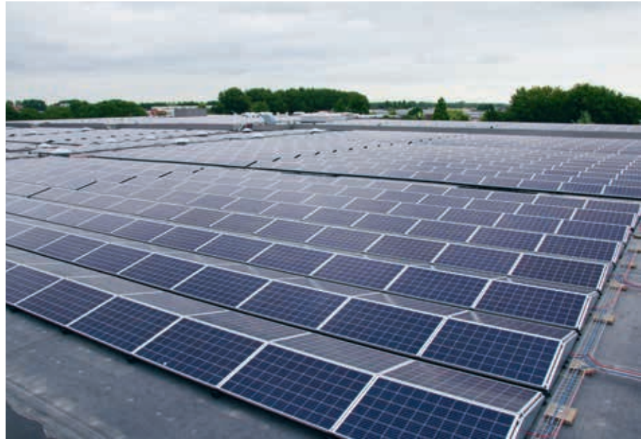
De daken worden opgeleverd inclusief tien jaar garantie op waterdichtheid. Daarna controleert J. Rip Loodgieters- en Onderhoudsbedrijf de daken een aantal keer per jaar en voert onderhoud uit indien noodzakelijk.
